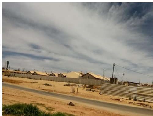
Figura 7 – Fotografia: Condomínio da PEL em construção: área alvo da permuta com a PMVC.
