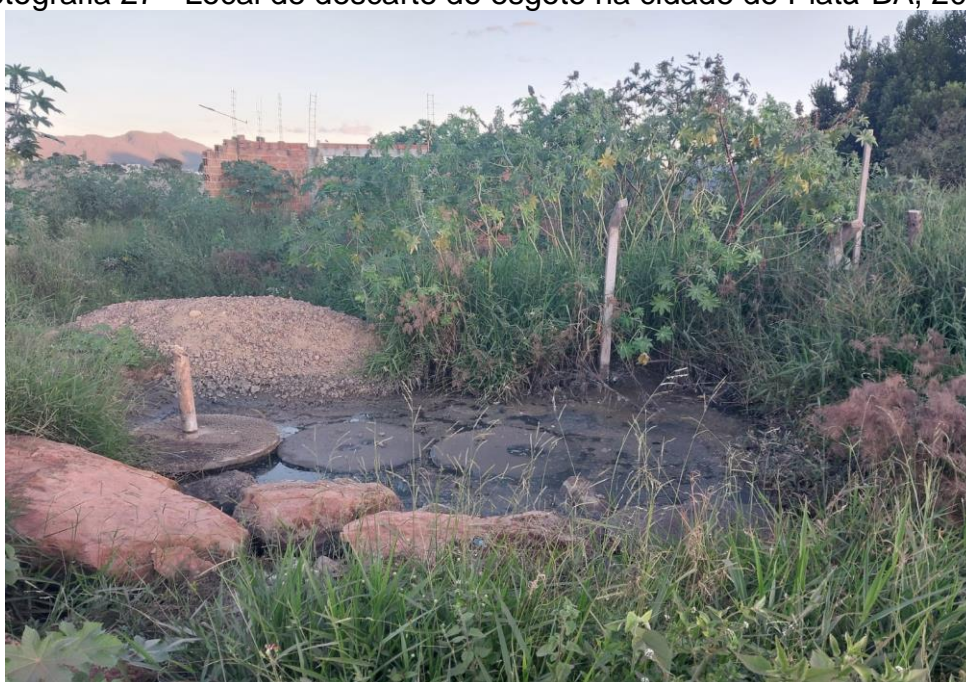
Fotografia 27 - Local de descarte do esgoto na cidade de Piatã-BA, 2022
